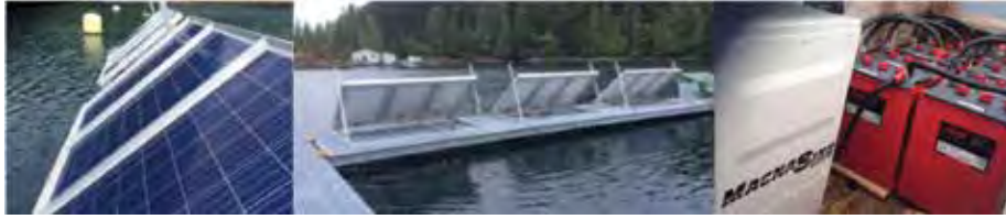
Composantes du système d'énergie renouvelable installées au site de Kyuquot SEAFoods Ltd. : panneaux solaires modulaires sur un quai (à gauche et au milieu), ainsi que des batteries de stockage et de l'électronique (à droite). Photo : Stephen Cross (UVic)
